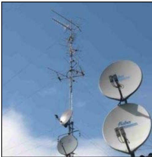
Figure 1 : Antennes de réception télévision
